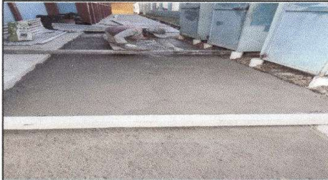
Foto1: Sustrucción de piso de torta de concreto
